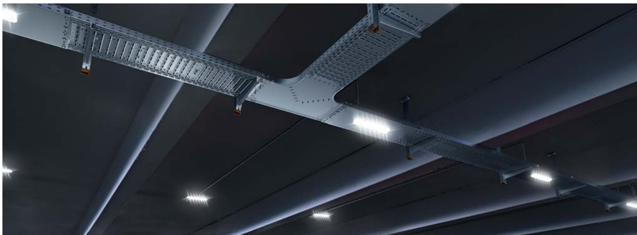
Рис. 3.29: Светодиодная система освещения крытой автостоянки
