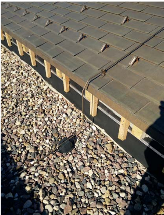
Медный круглый проводник и медный кровельный держатель на крыше инфраструктурного объекта «СПА-Барвиха», Московская область, Россия
