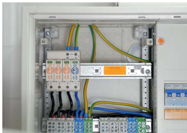
Монтаж комбинированного разрядника V50 типа 1+2 в зоне до счетчика
