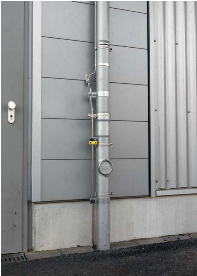
Рис. 2.18: Токоотвод молниезащиты на водосточном стояке
