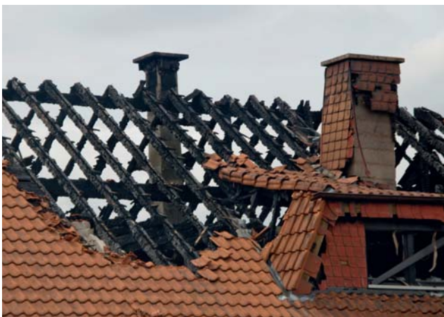
Рис. 1.19: Повреждения здания от прямого удара молнии
