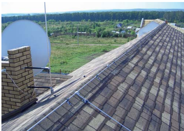
Дистанционный монтаж молниеприемника с применением стеклопластикового изолированного держателя для защиты кровельных надстроек жилого дома, Свердловская область, Россия
