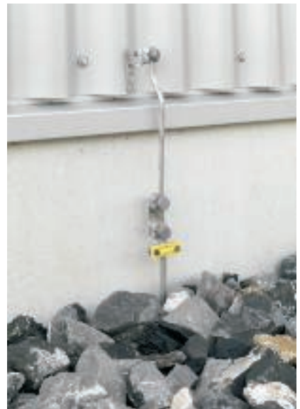
Место разъединения системы заземления
