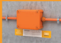
Установленная огнестойкая распределительная коробка FireBox с маркировкой.
