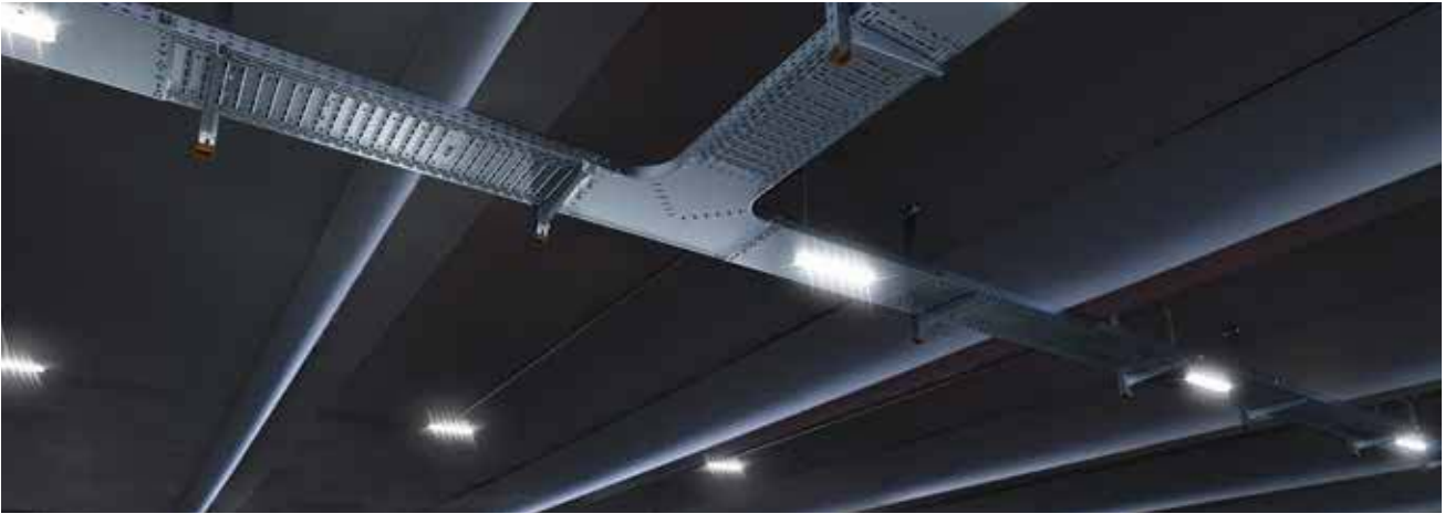
Рис. 3.29: Светодиодная система освещения крытой автостоянки
