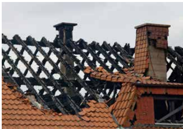
Рис. 1.19: Повреждения здания от прямого удара молнии
