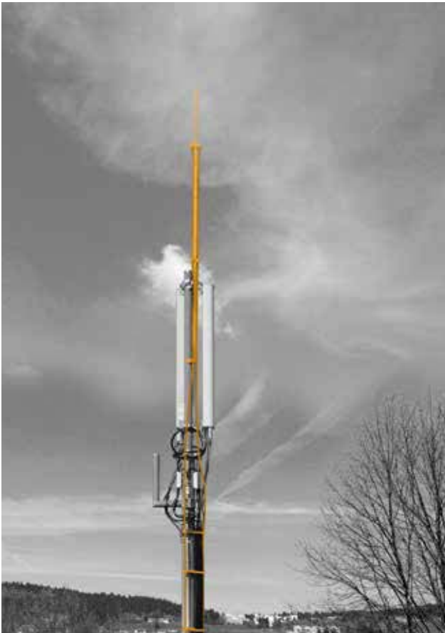
Рис. 2.72: Мачта мобильной радиосвязи с проводом isCon®
