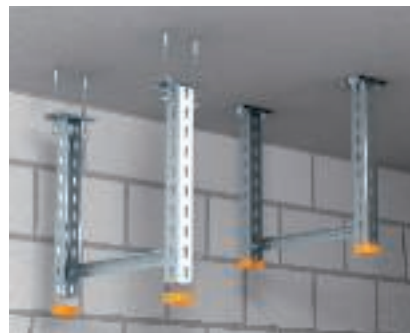
Траверса Монтаж U-образных подвесных стоек US 3 K, US 5 K и US 7 K под потолком с помощью анкерного болта и поперечной траверсы, состоящей из U-образного профиля US 3, US 5 или US 7.
