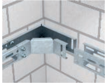
Установка фасонной детали кабельного лотка для монтажа светильников Монтаж фасонных деталей кабельных лотков для монтажа светильников.
