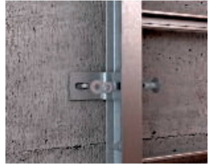
Крепление вертикального кабельного лотка лестничного типа промышленного исполнения Настенное крепление вертикального кабельного лотка лестничного типа промышленного исполнения осуществляется с помощью крепежных уголков BW80/55.
