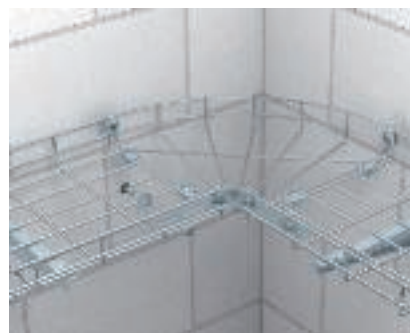
Монтаж угловой секции проволочного лотка Монтаж готовой угловой секции проволочного лотка с помощью стыкового соединителя GSV 34 и прокатной перфорированной ленты.
