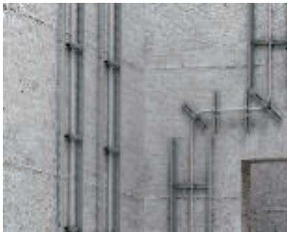
Вертикальная трасса Установленный вертикальный кабельный лоток лестничного типа.
